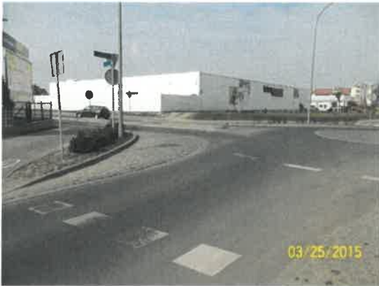
Skarpy, pobocza rozmycia do uzupełnienia
