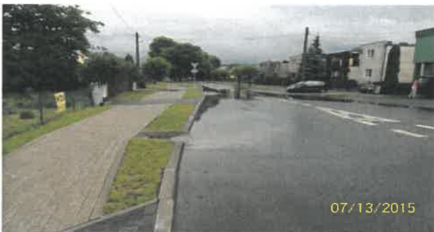
Zastoiska wody- wykonanie ścieku lub frezowanie i powtórne profilowanie
