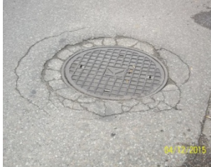
spękanie wokół studni
