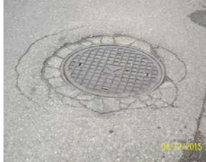
spękanie wokół studni
