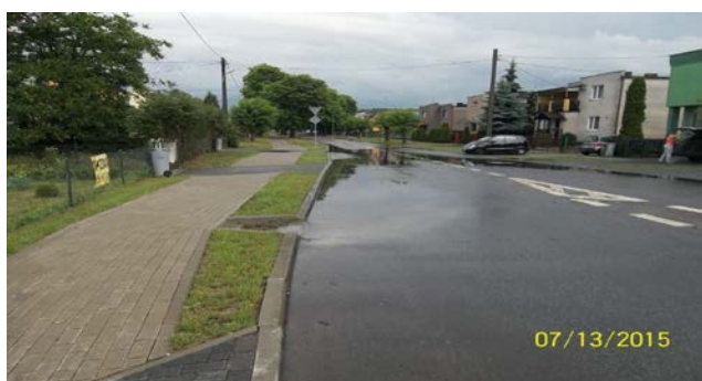
Zastoiska wody- wykonanie ścieku lub frezowanie i powtórne profilowanie
